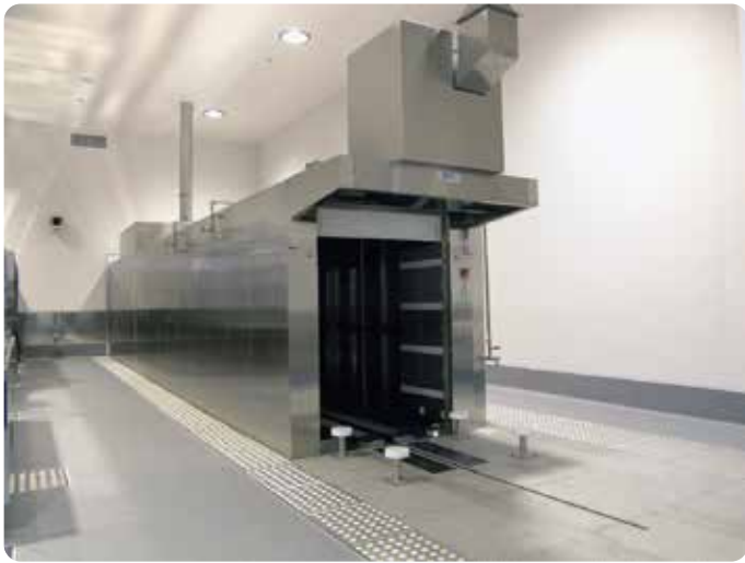
洗浄機室 AGS20-2・アルミチェッカープレート
