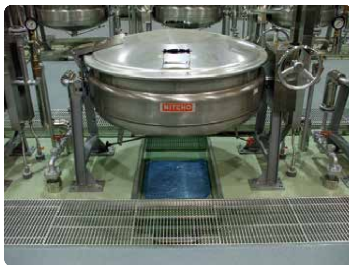
釜下保護プレート・AG20-2
